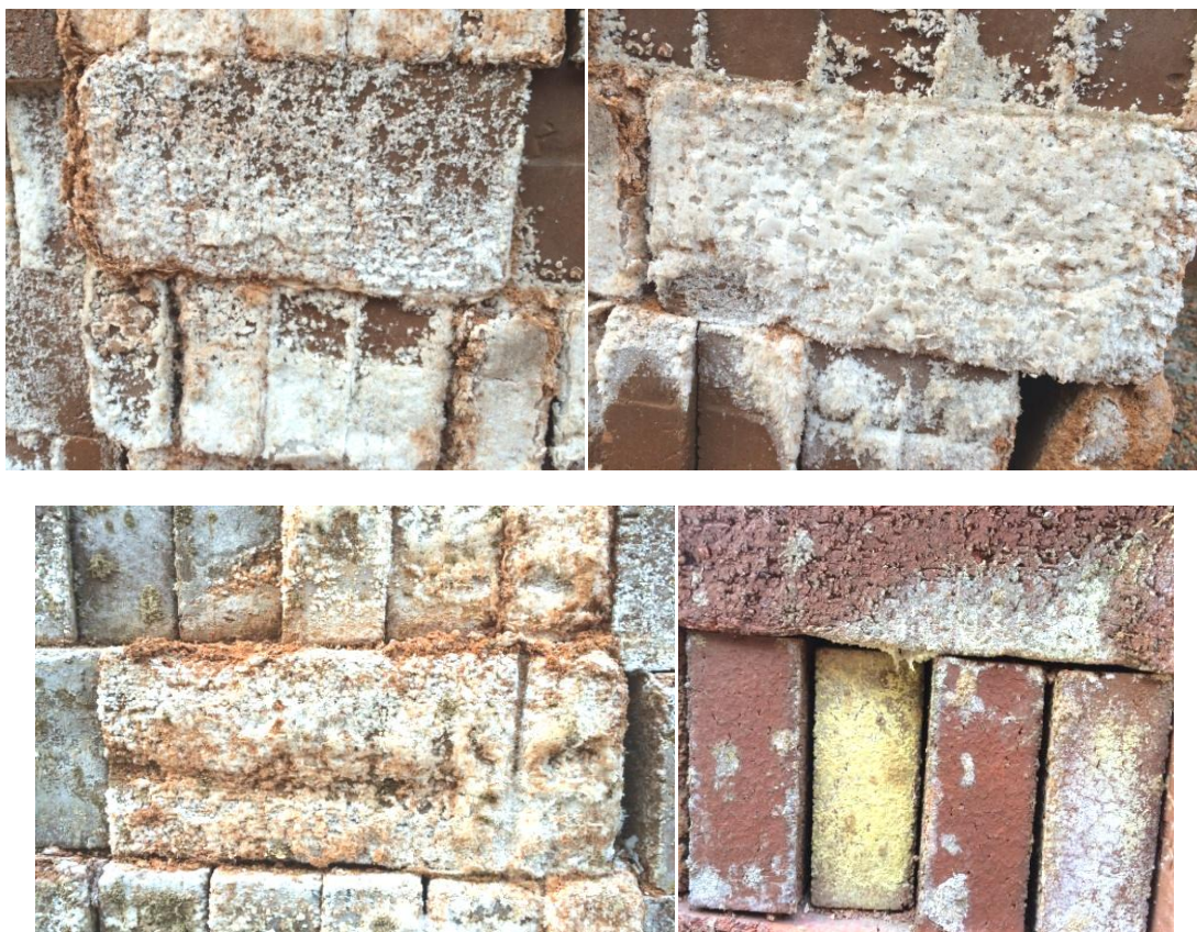
内燃掺料含硫太高，产品未出厂造成的泛霜——皖南某地
